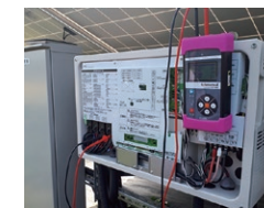
インバータインピーダンス及び 開放電圧測定
